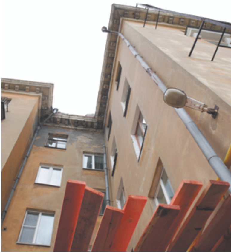
Готовится проект ремонта фасада и восстановления лепнины под крышей дома у «Комсомольца»
