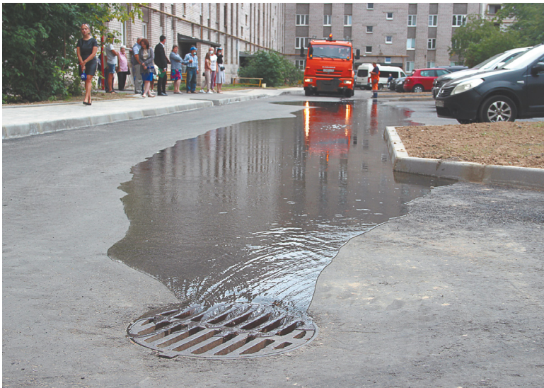
В засушливое лето дворы после ремонта стали проверять с помощью поливальных машин. На Химиков, 12 это помогло найти недостатки
