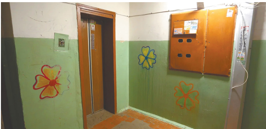
Дом на Гоголя, 6 под управлением «КапиталСтройСервиса» — предмет многочисленных обращений жителей
