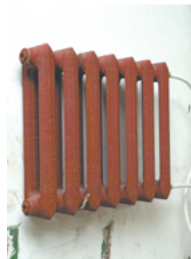
Жильцы добились восстановления батарей в подъездах
